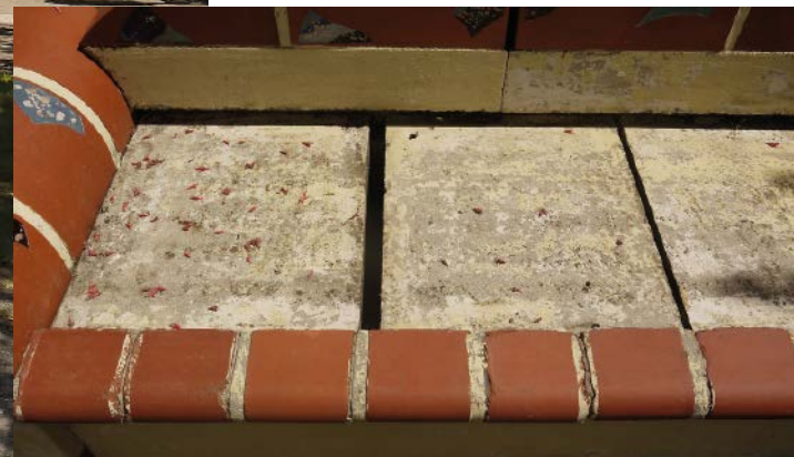
Mangelhafte Oberfläche, Spalten und Risse machen die Bank zur Gefahr für ältere Menschen.
